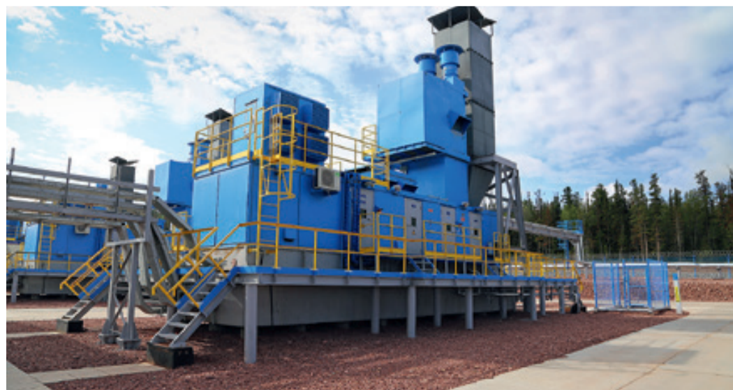
Электростанция собственных нужд газового промысла Ковыктинского ГКМ
